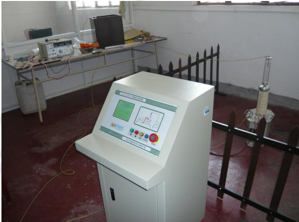
上海崇明岛绝缘材料厂现场图片
